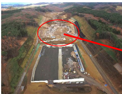
造成状況 (全景)
